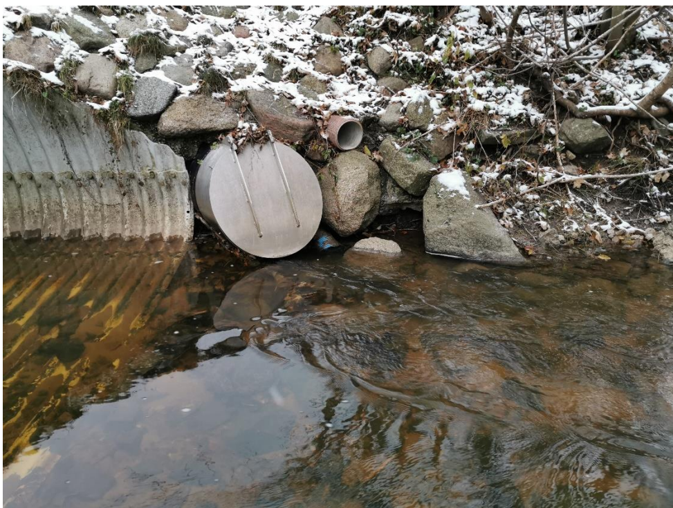
Figur 2: RBU G200V01, består af et metalrør med klap. Der er ingen tegn på ristestof, lammehaler eller bakteriebelægninger. Der er ingen tegn på erosion. I PULS ligger prikken på den forkerte side af vejen. Vandet er klart og der er et fint flow i vandløbet. Vandløbsbunden består af store sten, gydegrus og fint grus.
